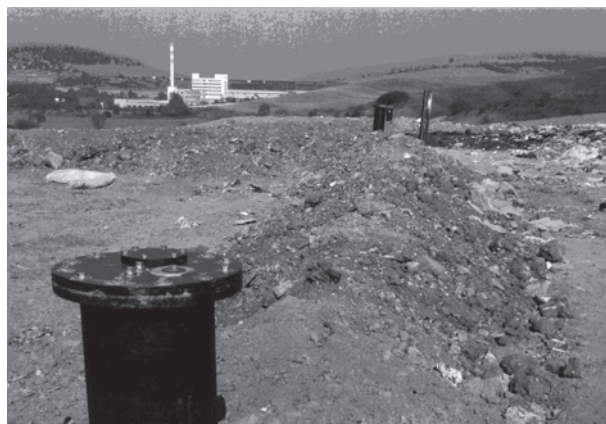
Odplyňovací vrt na skládke komunálneho odpadu. Foto: archív autorov
