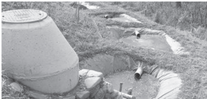
Čistiareň odpadových vôd Tichý Potok – vodné kaskády ako stupeň dočistenia po pieskovom filtri. Foto: R. Zvara
