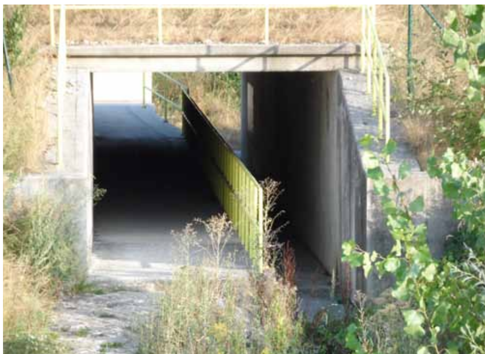
Obr. 1. Viacúčelový podchod v zmysle odporúčania TP 04/2013 (2013) (hore) a skutočné riešenie na diaľnici D3 (dolu) – podchod po uvedení diaľnice do prevádzky nie je udržiavaný (Žilina, Horný Hričov, 2013). Foto: Daniela Ďurčanská
